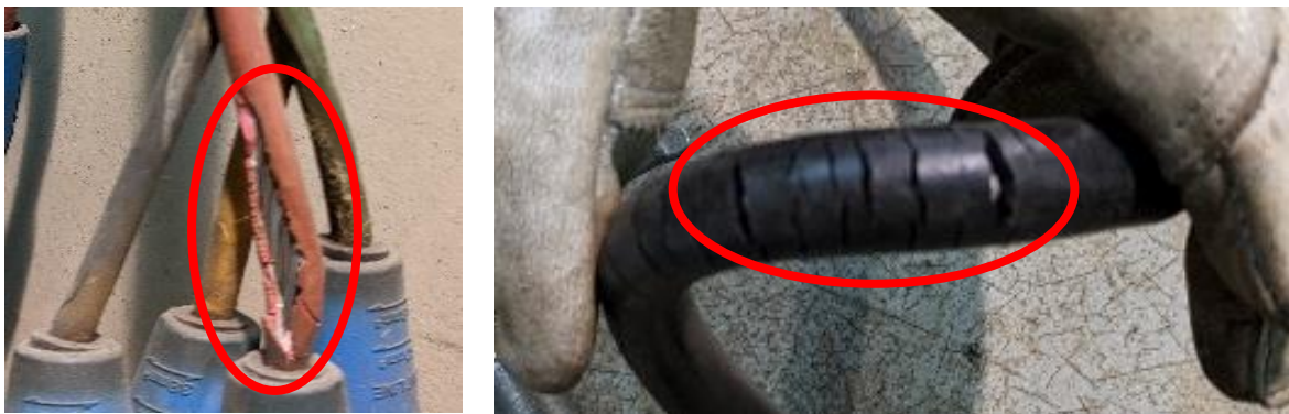
写真. 劣化損傷を生じたケーブル（左：溶接機入力ケーブル、右：トーチケーブル）
