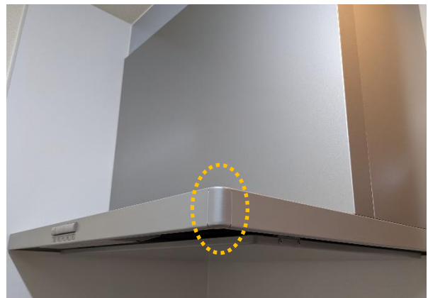
写真. 換気扇ダクトカバー
