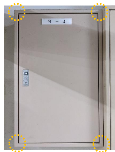
写真. 配電盤のボックス
