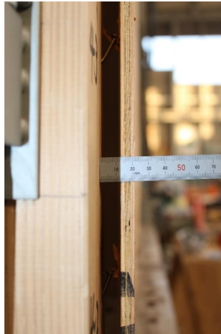
③面材の浮き(13mm)と釘のパンチング状況
