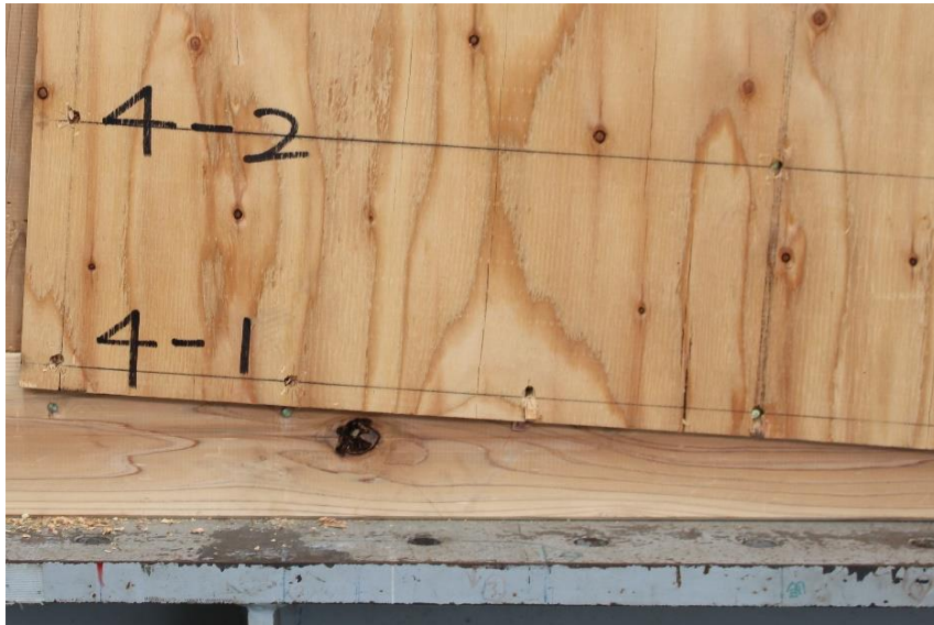
② 釘のパンチングシア状況
