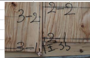
①継手間柱部分の 面材の割裂の状況
