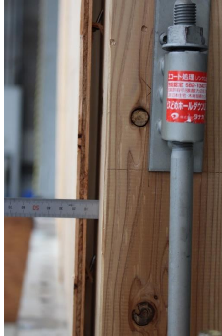
③面材の浮き(10mm)と釘のパンチング状況
