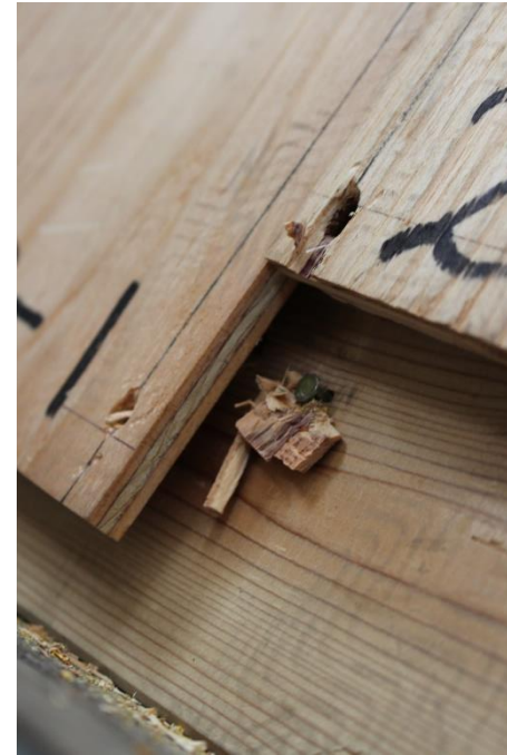
③ 面材の割裂破壊の状況
