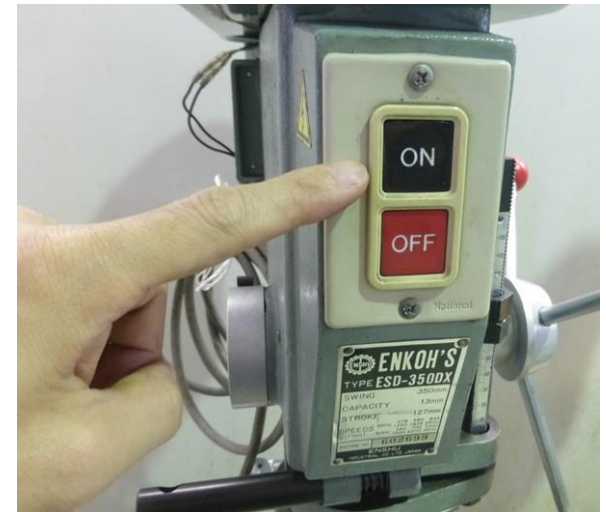
電源の起動と停止動作を確認する
