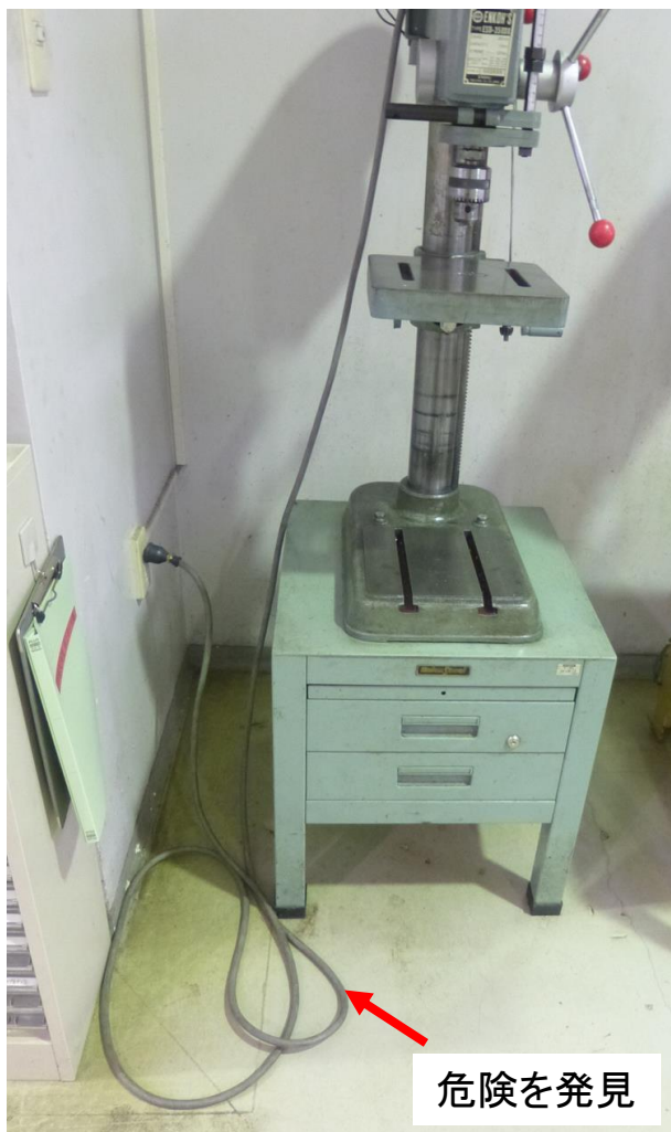
床に垂れた危険な配線
