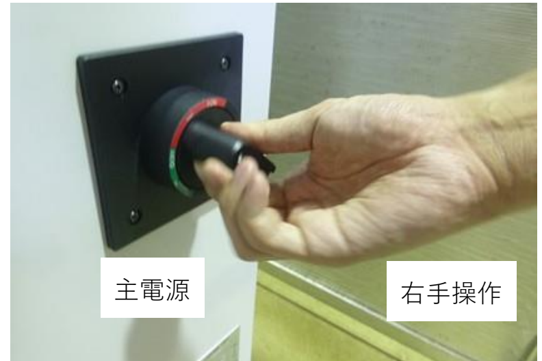
主電源操作方法の確認
