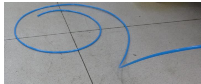
エア配管が外れた状態
