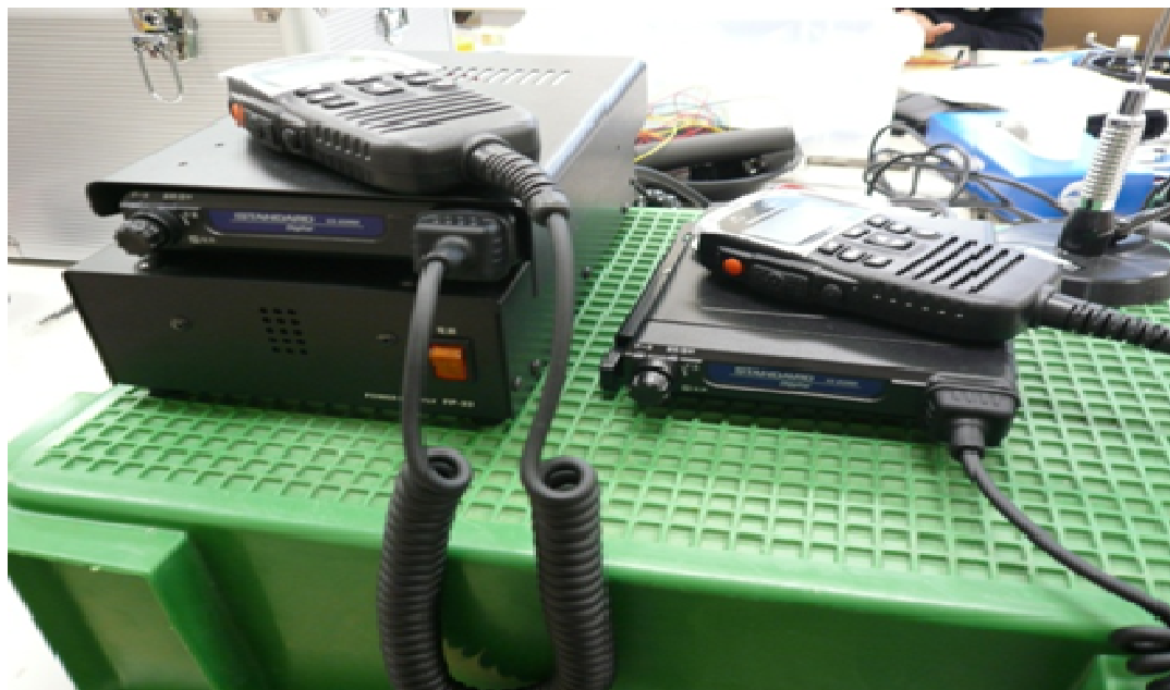
図10 デジタル無線通信機
