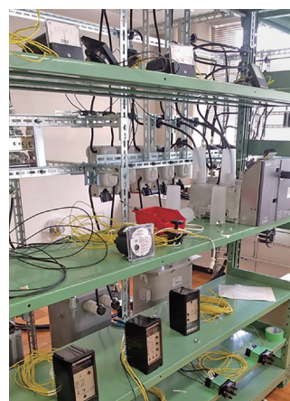
図3 真空遮断器と継電器類、計器類の様子
