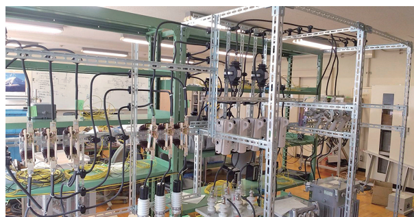
図4 開閉器類の様子
