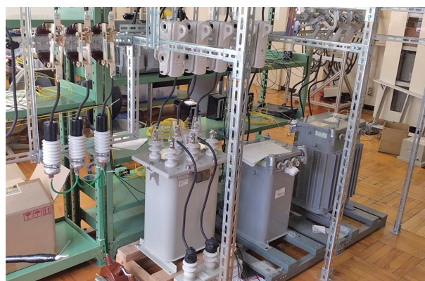
図5 変圧器類と進相コンデンサ類
