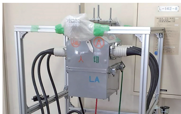
図2 柱上気中負荷開閉器の実習装置
